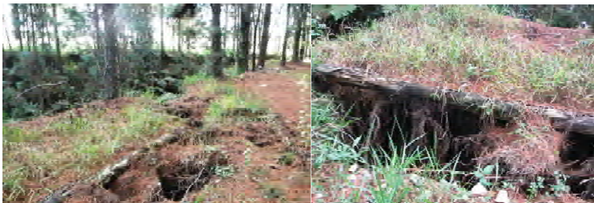
Figura 6.7 – Solapamento de margem de corpo d'água.
