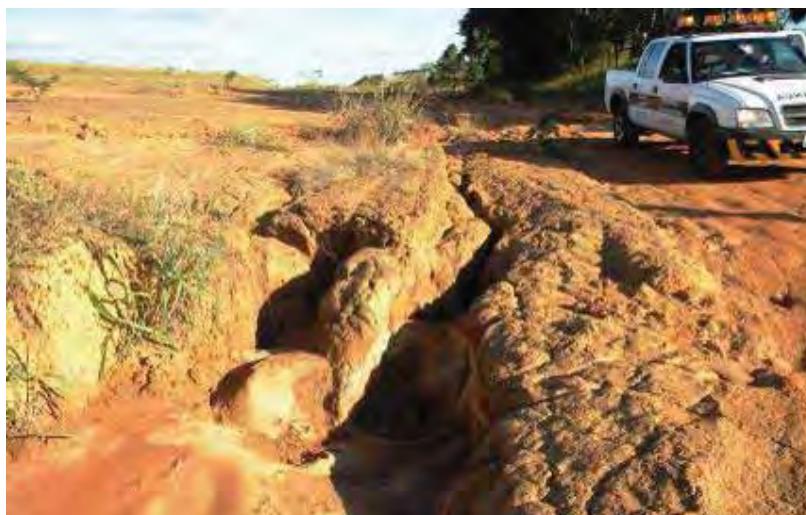
Figura 6.9 - Foco erosivo em sulcos.
