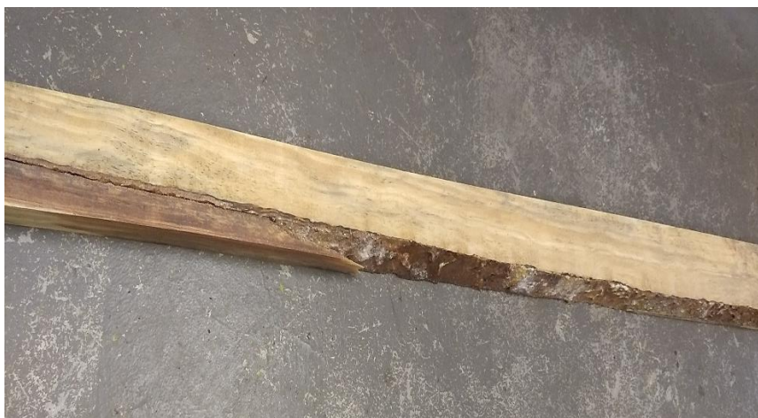
Figura 8. Defeito que diminuiu o comprimento do CP2.
