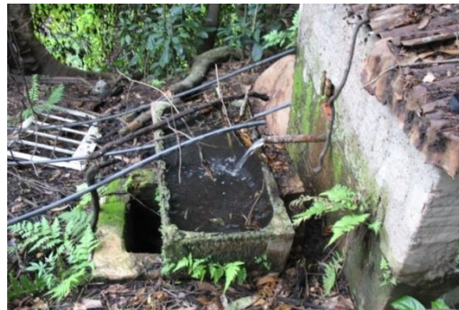
Figura 7.52 – Detalhe da mina no ponto BRU 54.
