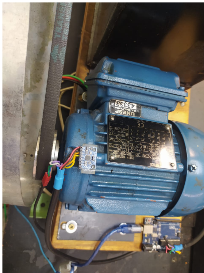
Figura 33 - Acelerômetro montado no motor elétrico W22
