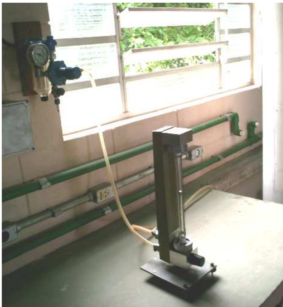
Figura 5.4: Válvula reguladora de pressão e rotâmetro instalados
