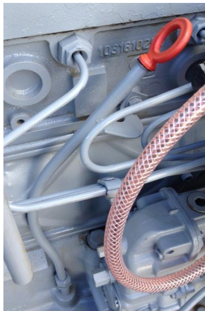
Figura 23. Sistema de monitoramento manual do nível de óleo lubrificante.
