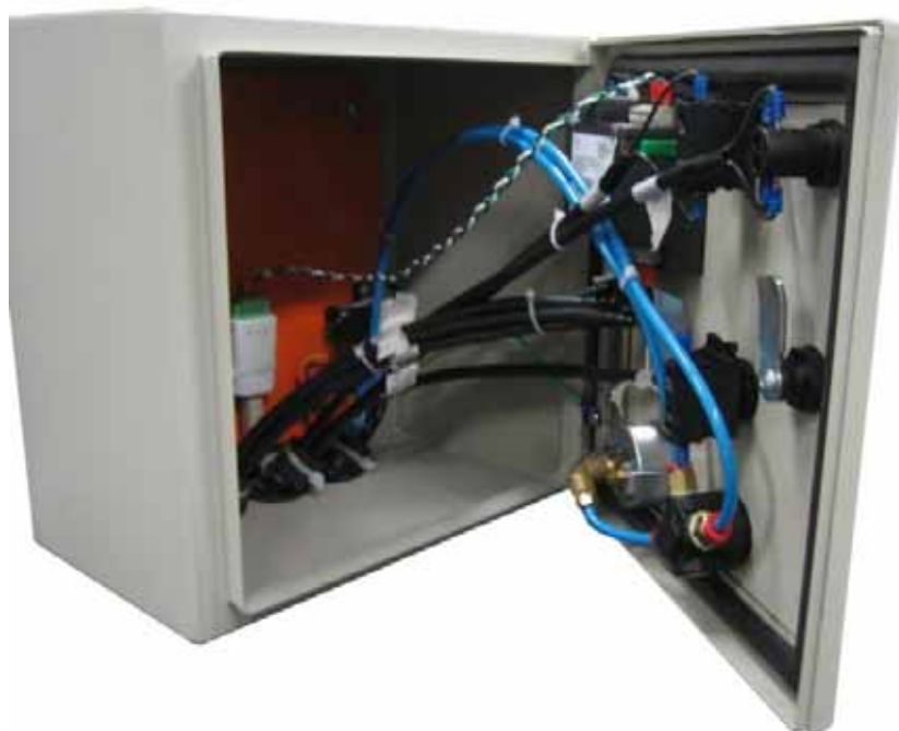
FIGURA 3.24 – Painel elétrico lateral.
