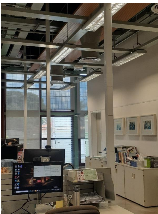
Figura 56 - Dutos setor administrativo - Sesc Birigui.
