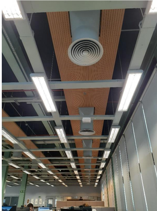
Figura 21 - Dutos e tubulações - Sesc Birigui.
