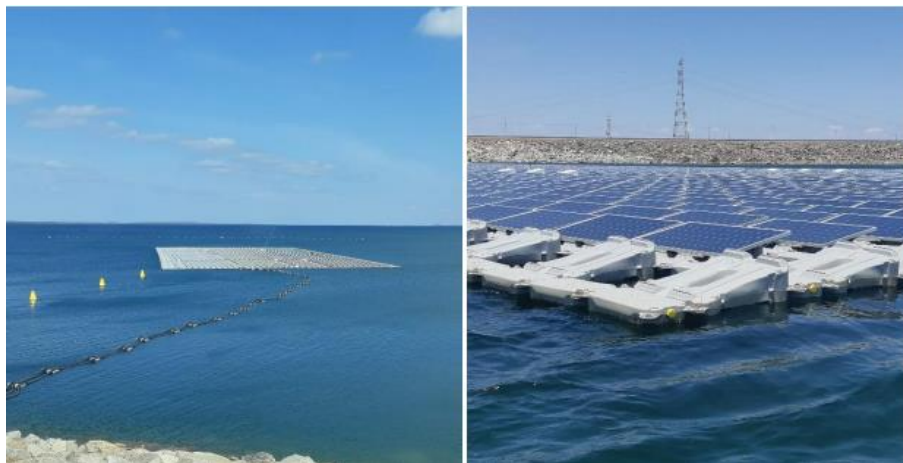
Figura 48 – Usina fotovoltaica flutuante no reservatório da UHE Sobradinho
