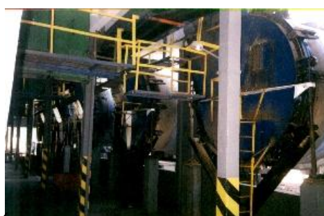
Entrada do lixo no biodigestor
