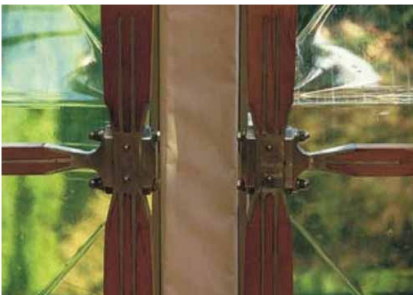
Figura 23 – Detalhe da junção entre os elementos e entre os módulos. Fonte: http://www2.ufp.pt/~avoliv/trab%20teo%20alunos/piano-marcos.pdf .
