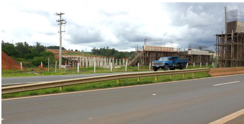
Figura 18: Obra da ponte que atravessará o rio Piracicaba e a rodovia Laércio Corte (SP-147) e ligará o parque automotivo ao anel viário.
