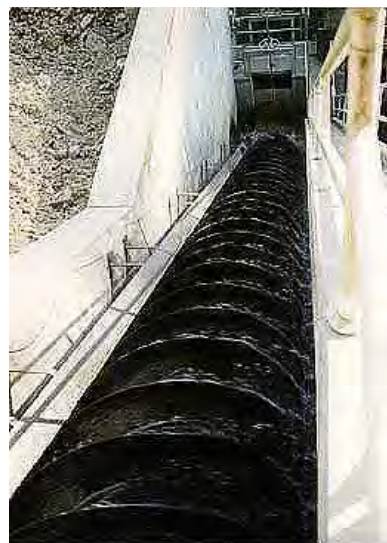
Figura 2 - Bomba de Arquimedes em Uma Estação de Tratamento de Água.
