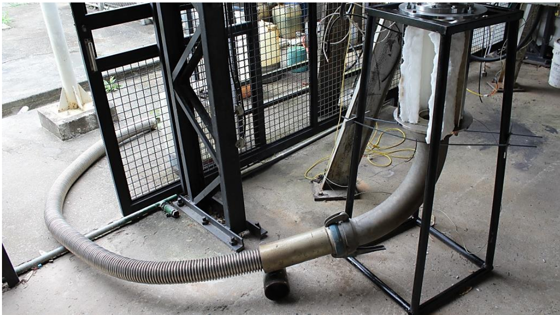
Figura A. 14 - Linha de exaustão da câmara
