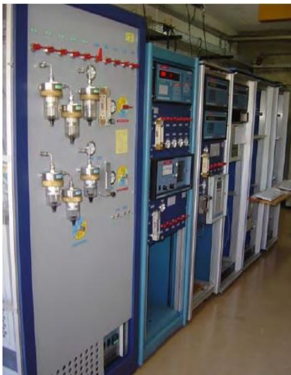
Figura 3.5 - Arranjo físico dos analisadores de gases dispostos nos painéis
