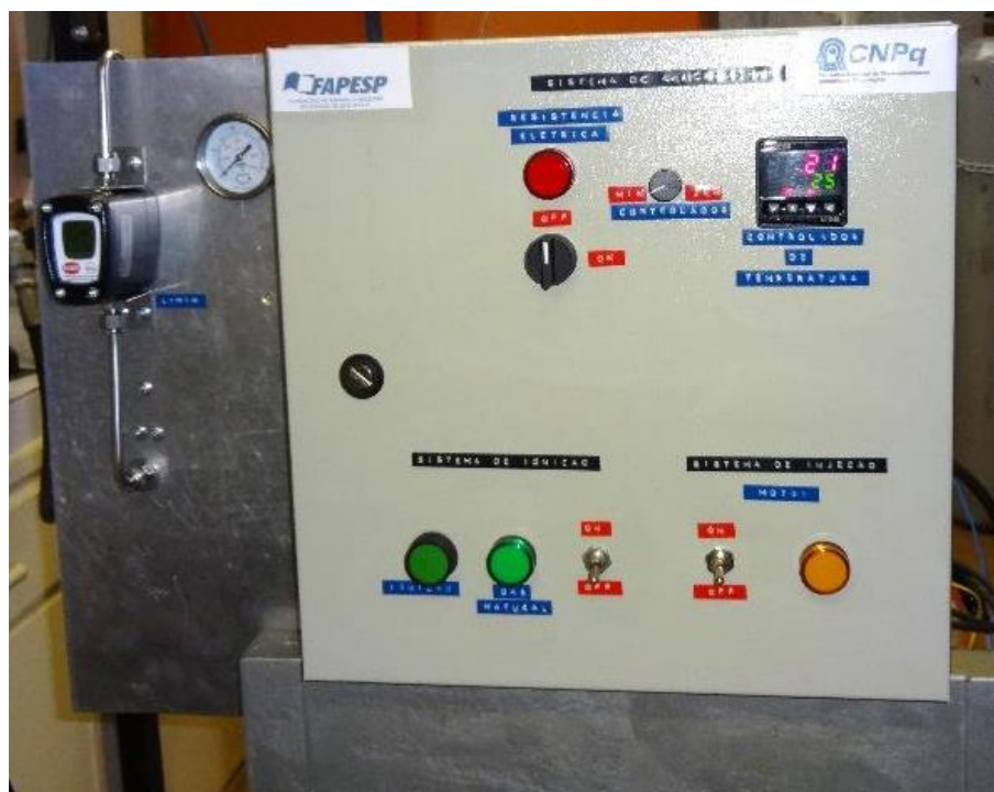
Figura A. 11 - Painel de controle dos periféricos
