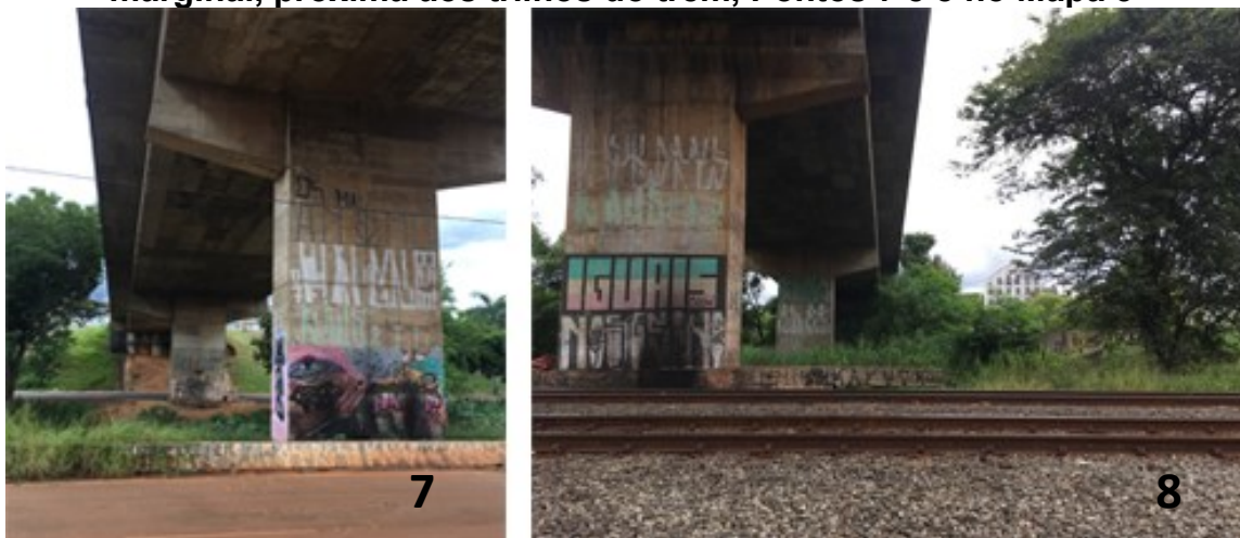
Figura 37 – Parte abaixo do Viaduto Laércio Corte, considerada área marginal, próxima aos trilhos do trem, Pontos 7 e 8 no Mapa 3
