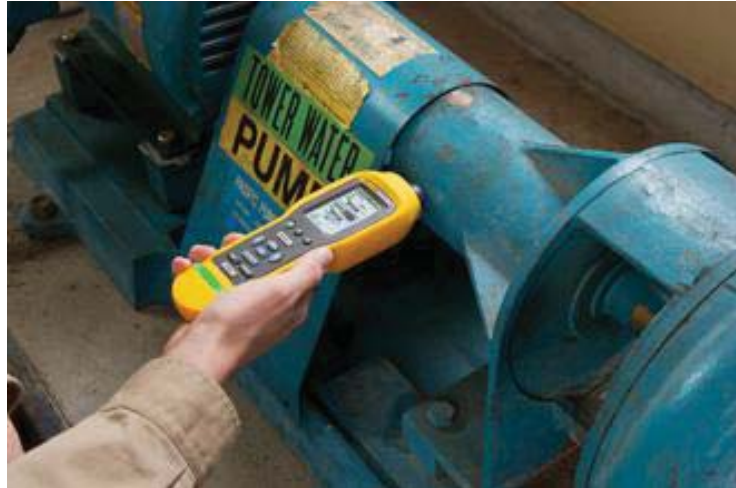
Figura 15 – Exemplo de aplicação do instrumento em bomba de água
