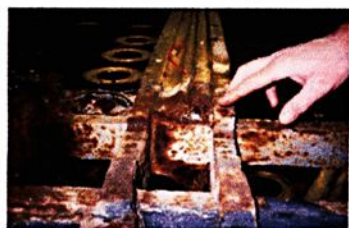
Figura 38: Oxidação de metal.
