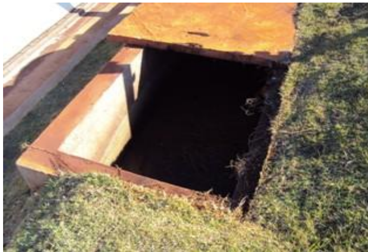
Figura 1. Caixa de entrada da rede de esgoto da Copercana, Sertãozinho - SP.
