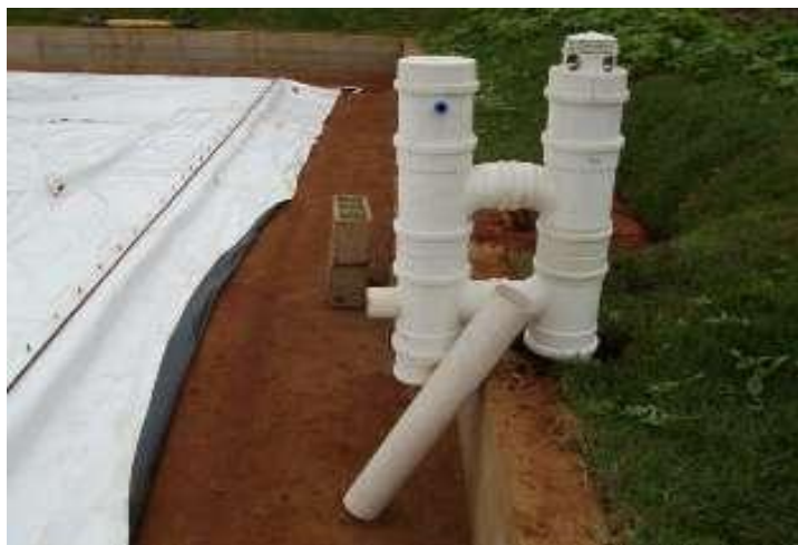
Figura 5. Registro e válvula de alívio para saída do biogás.
