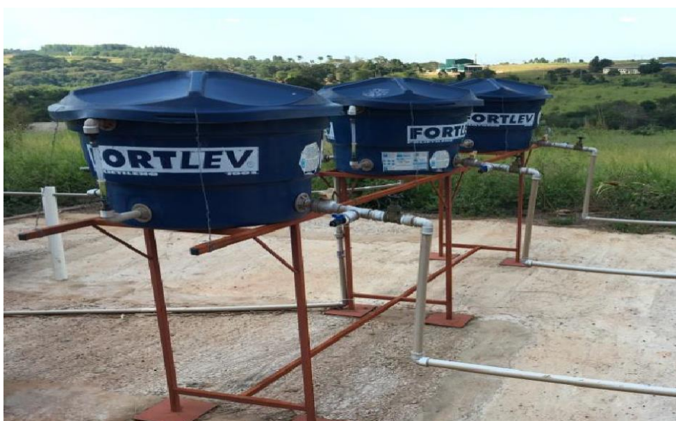
Figura 17- Caixas de distribuição de efluente
