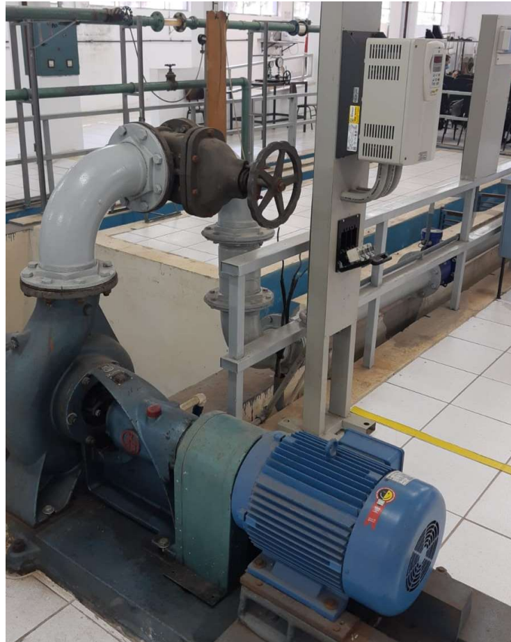
Figura 16 - Sistema de bombeamento utilizado no ensaio.
