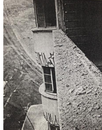
Figura 62 - Degradação da fachada
