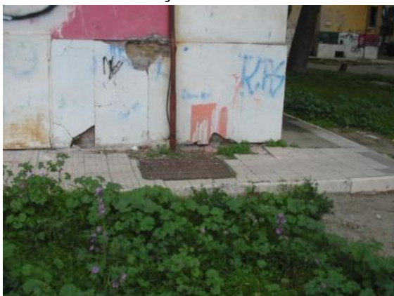
Figura 20 - Pavimento térreo, abandono e falta de manutenção do edifício
