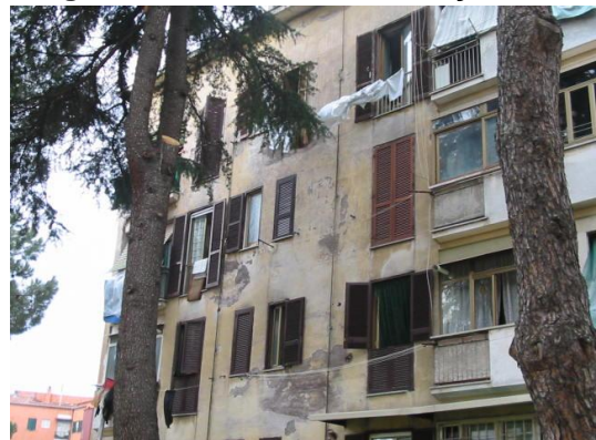
Figura 19 - Detalhe das janelas degradadas, antes da intervenção
