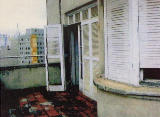
Figura 63 - 13º pavimento degradado
