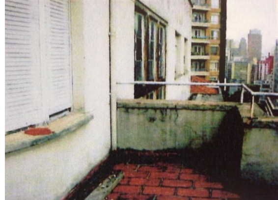
Figura 64 - 13º pavimento degradado
