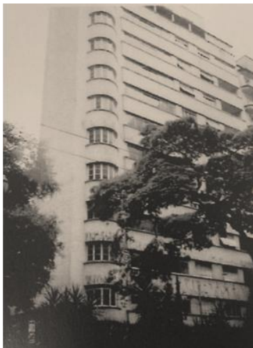
Figura 57 - Fachada degradada do Edifício Maria Paula
