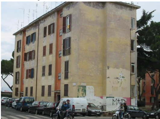
Figura 18 - Fachada degradada antes da intervenção
