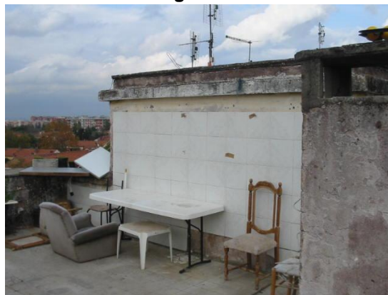
Figura 21 - Falta de manutenção e abandono da antiga lavanderia
