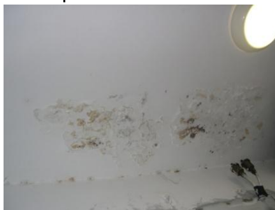
Figura 23 - Mofo e infiltração na parede de um apartamento
