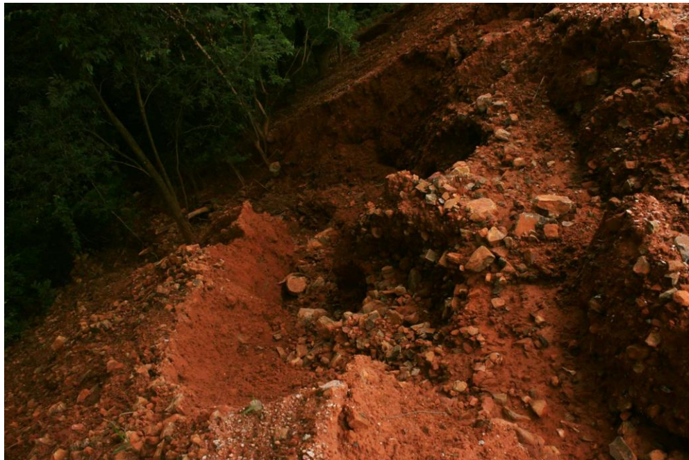
Figura 8 - Sulco e agregados no solo de terraplanagem do Condomínio Residencial Pampulha.
