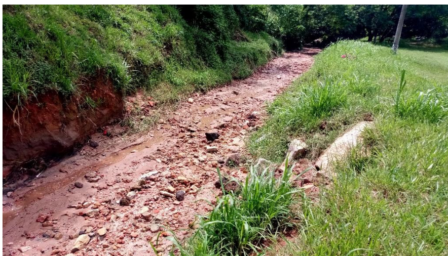
Figura 9 - Assoreamento do Córrego Piratininga causado por erosão do solo.
