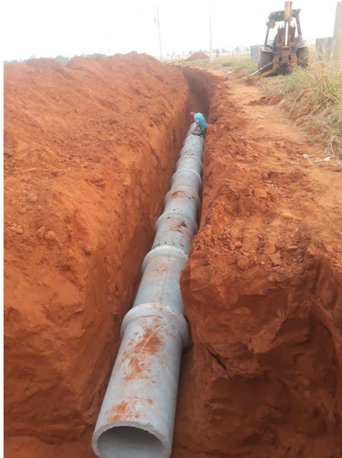
Figura 3: TUDO de concreto em rede de drenagem pluvial
