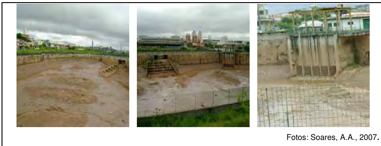
Fig.12 – Situação atual do reservatório Aricanduva V.
