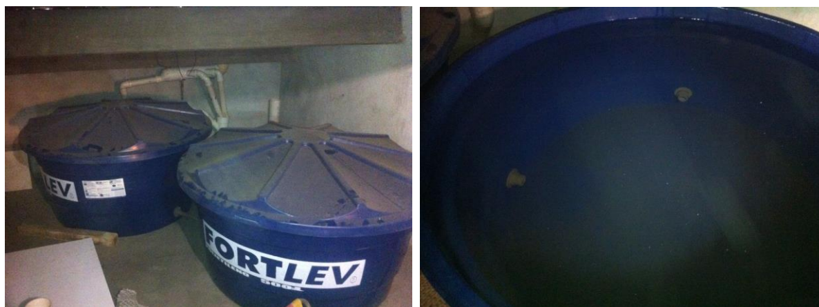
Figura 8 - Reservatórios: caixas d'água (1 e 2) instaladas na residência do município de Barueri (SP) à esquerda; Reservatório com a capacidade máxima de reservação à direita.
