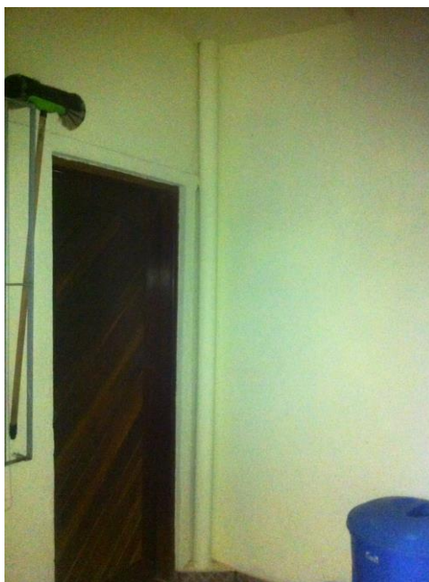
Figura 11 - Canalização para condução do excedente de água de chuva do sistema de captação ao sistema de drenagem urbana do município de Barueri (SP).
