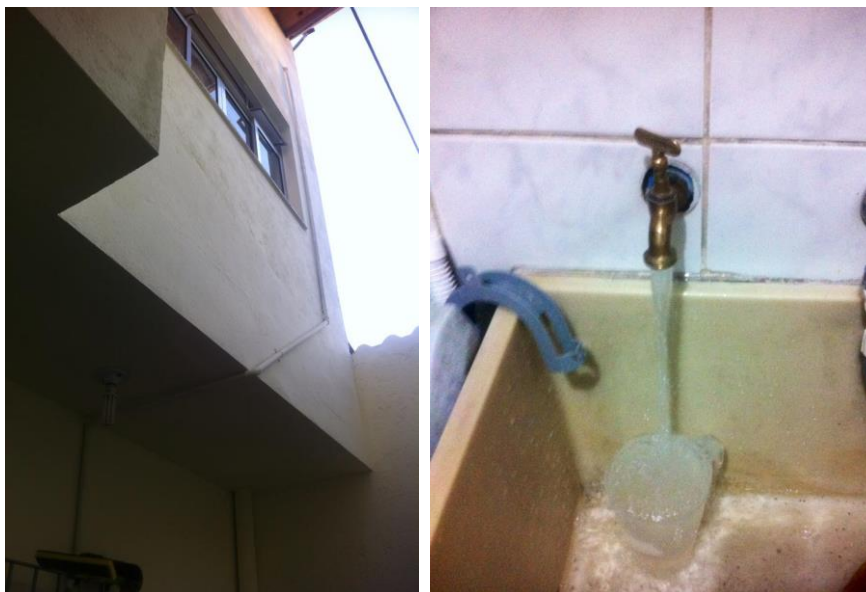
Figura 10: Sistema de condução da água de chuva reservada até a torneira da área de serviço da residência do município de Barueri (SP).
