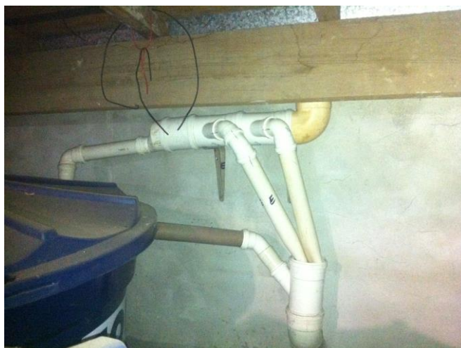
Figura 7 - Sistema de distribuição utilizado para a condução da água de chuva captada para os reservatórios, instalado na residência do município de Barueri (SP).
