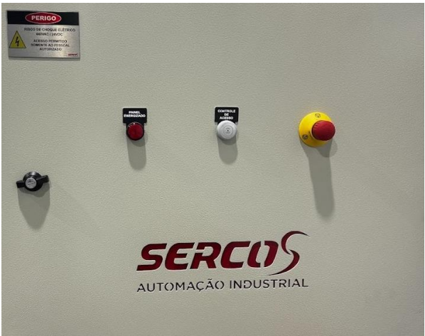
Figura 39 – Botão de emergência do painel elétrico de comando
