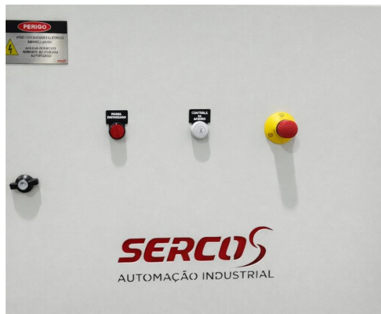
Figura 46 – Sinalização de segurança do painel elétrico de comando
