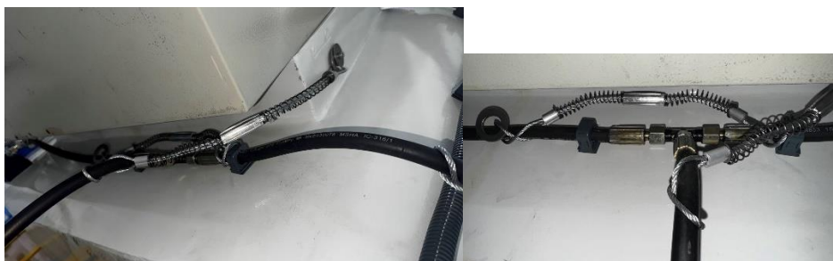
Figura 53 – Cabos de aço para contenção de mangueiras na fase traseira da máquina próximo ao painel
