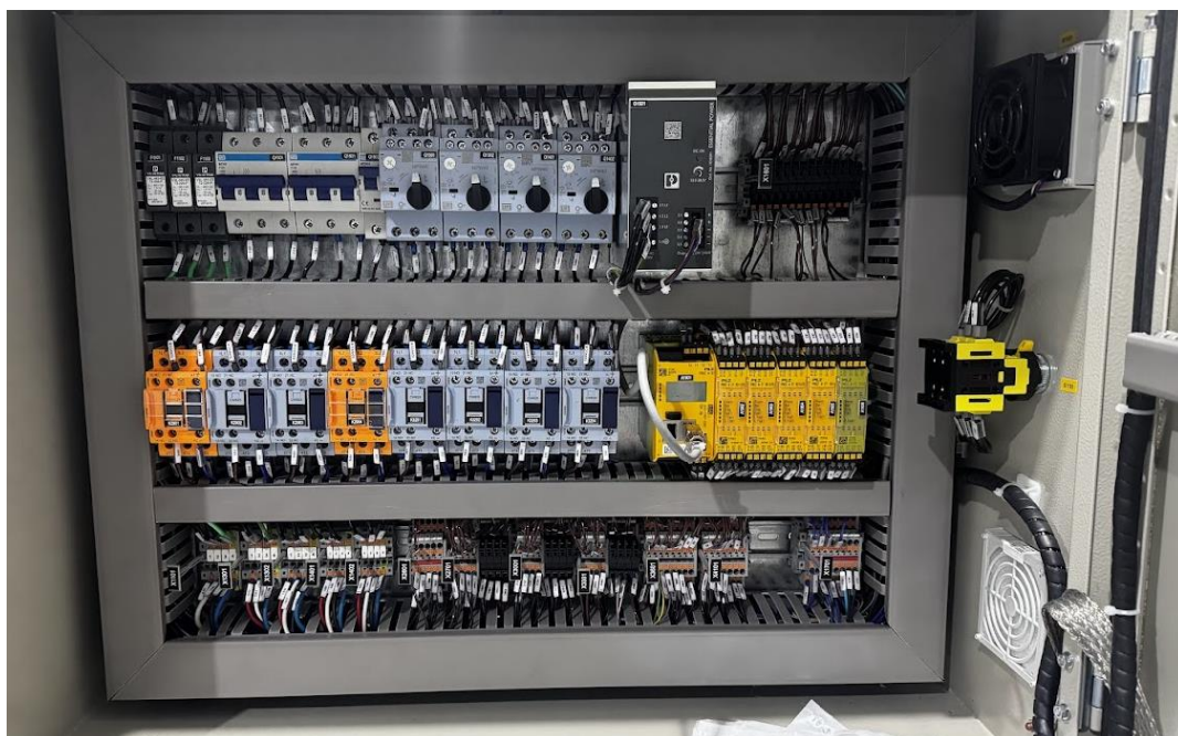
Figura 40 – Parte interna do painel elétrico adequado
