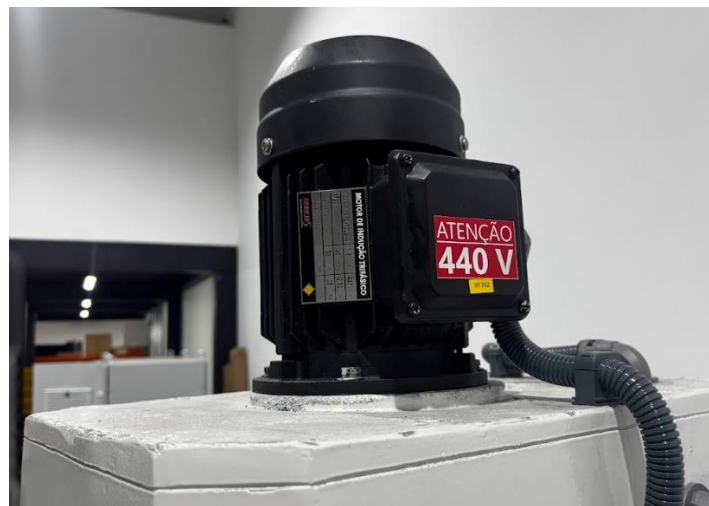
Figura 48 – Sinalização de alerta de local com tensão elétrica no motor principal
