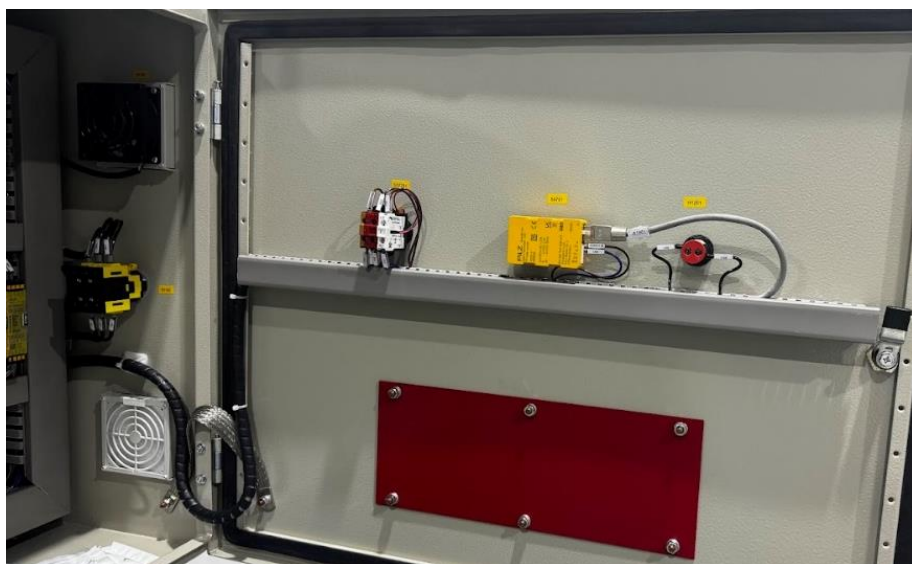
Figura 41 – Parte interna da porta do painel adequado
