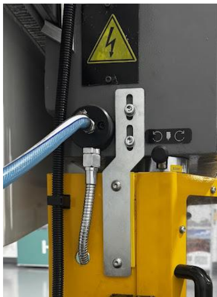
Figura 49 – Sinalização de perigo de choque elétrico próximo à proteção do mandril
