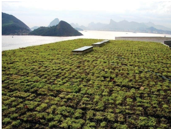
Figura 22 – Telhado verde do tipo alveolar
