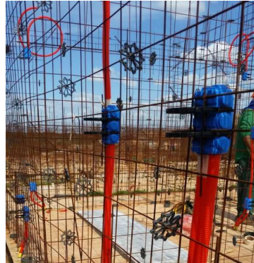
Figura 8. Disposição elétrica nas paredes.
