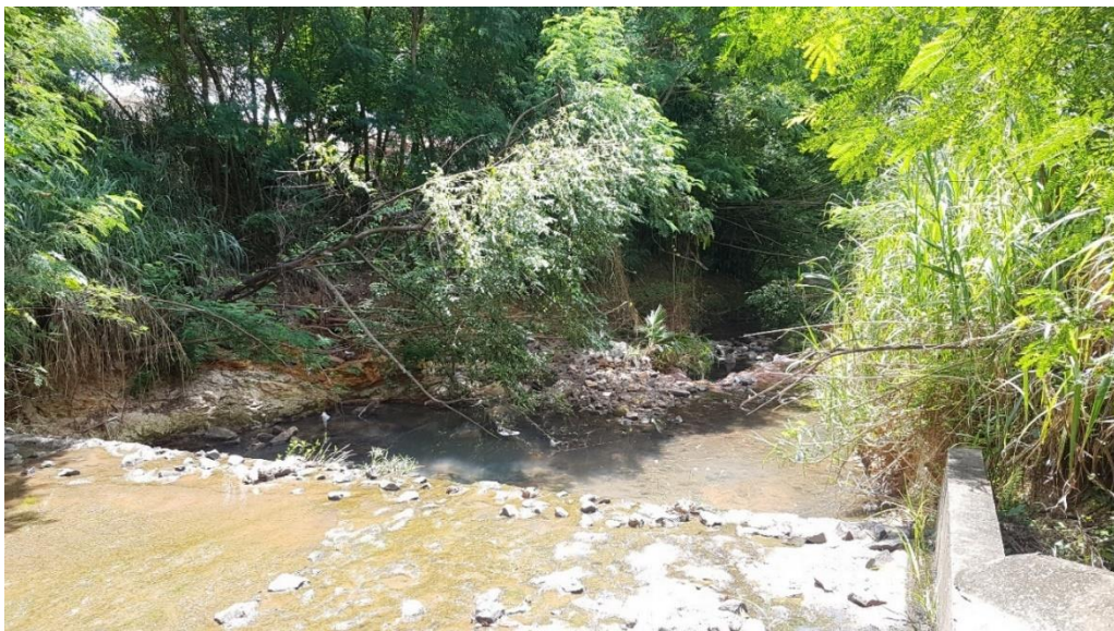
Figura 33: Processos erosivos no córrego
