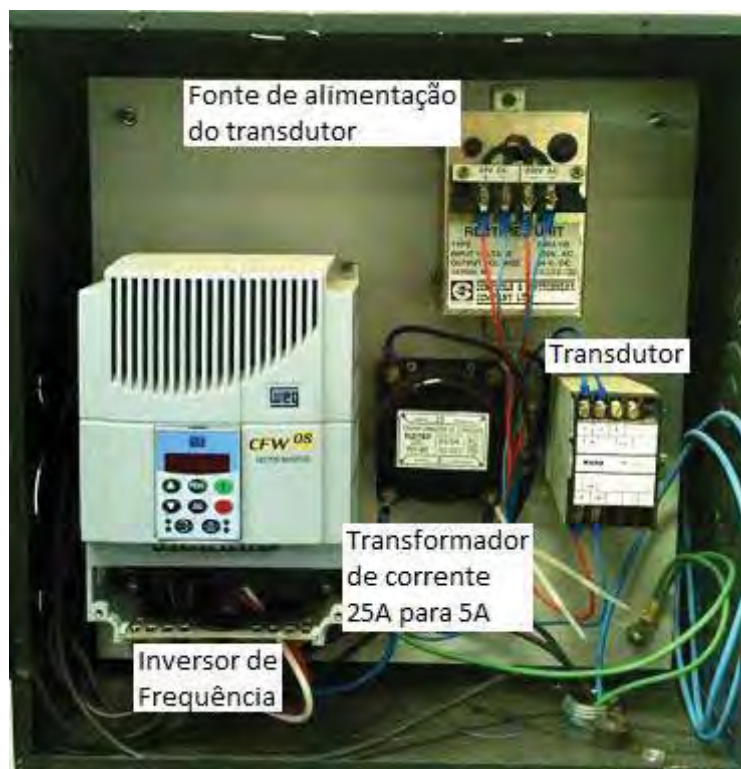
Figura 20 - Painel de comando dos equipamentos.
