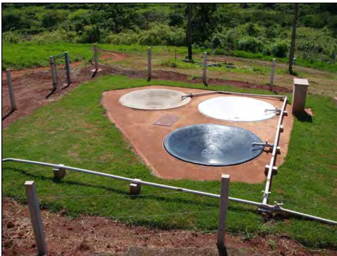
Figura 8 – Sistema de desinfecção solar.
