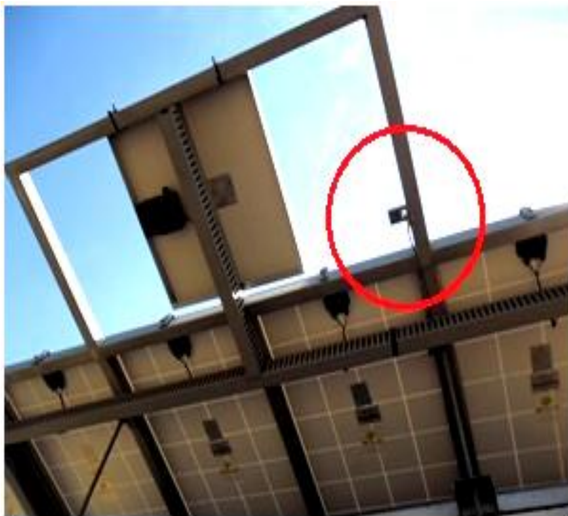
Figura 19-Sensor de irradiação PVS1 fixado no suporte do painel
