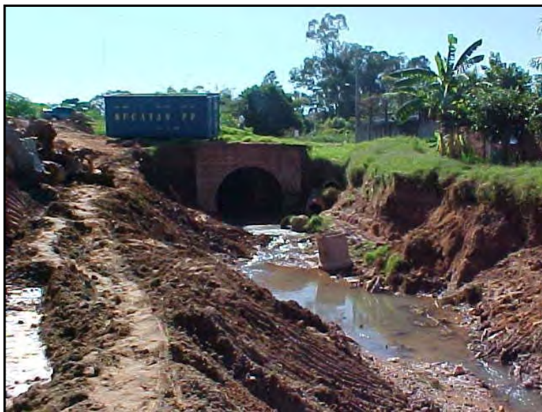
Figura 11: Invariavelmente moradores residentes na área de Preservação Permanente do córrego das Colônia Mineira sofrem transtornos, devido a inadequada canalização fechada instalada neste local, que não suporta o volume das águas pluviais. Fonte: Pesquisa de Campo (2003), Autora: Adriana Olivia Alves.
