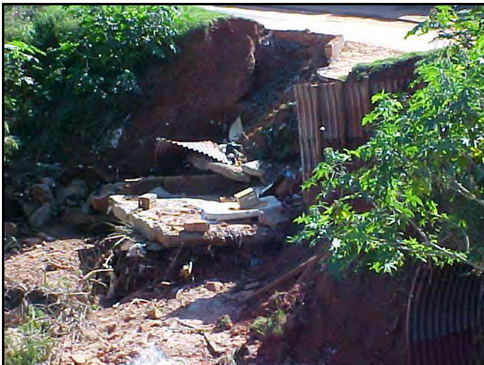
Figura 24: Desbarrancamento das placas de concreto no término da canalização fechada na Geni. Fonte: Pesquisa de Campo (2002). Autora: Adriana Olivia Alves.
