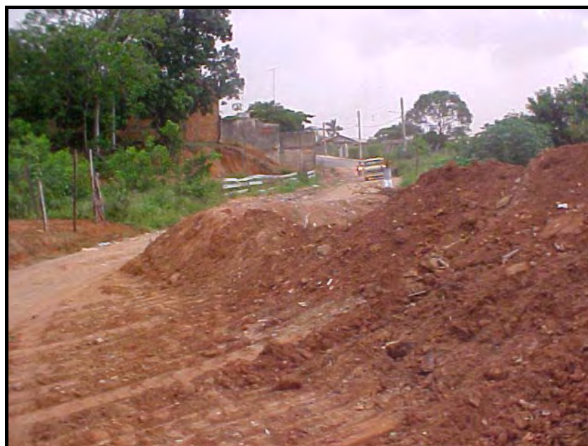
Figura 13: Movimentações de terra e ausência de pavimentação na rua Angeli: conseqüente assoreamento do córrego da Colônia Mineira entre o canal canalizado fechado e a canalização aberta. Fonte: Pesquisa de Campo (2002). Autora: Adriana Olivia Alves.
