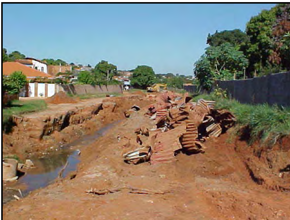
Figura 16: Várias moradias sofreram com as enchentes causadas pela ocupação inadequada na área de Preservação Permanente e pela canalização que não suporta a quantidade de águas pluviais na época das chuvas, diante disso, a Secretaria de Obras planeja substituir a canalização de armico o por concreto a vila Geni bairro. Fonte: Pesquisa de Campo (2002). Autora: Adriana Olivia Alves.
