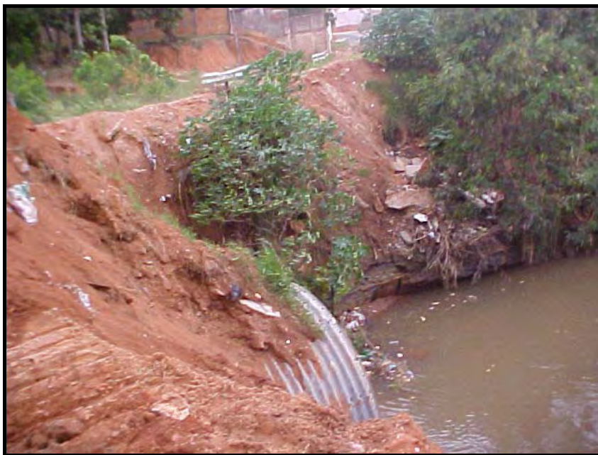
Figura 14: Local de destino das movimentações de terra entre a canalização fechada e as proximidades da foz do córrego da Colônia Mineira na Vila Geni: processo contínuo de assoreamento. Fonte: Pesquisa de Campo (2002). Autora: Adriana Olivia Alves.
