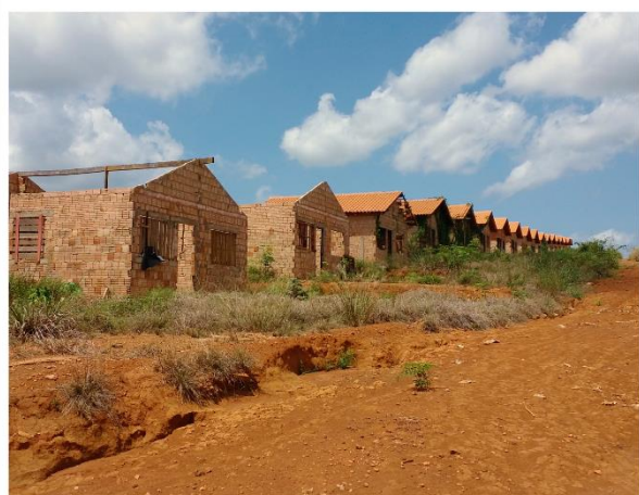
3. Construções tomadas pela vegetação no Ilha do Arapujá Fonte: Trabalho de Campo realizado em 04/08/2016
