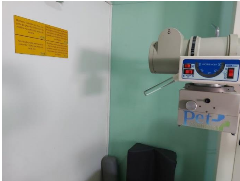
Figura 11: Avisos obrigatórios segundo a RDC 330 dentro da sala de Raios X
