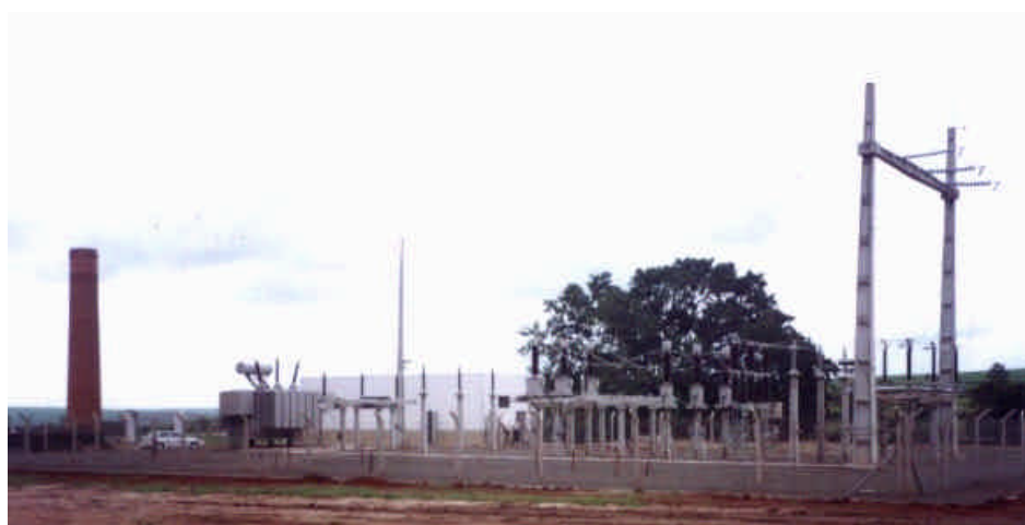
Figura 3 – Subestação de energia elétrica da usina Barra Grande
