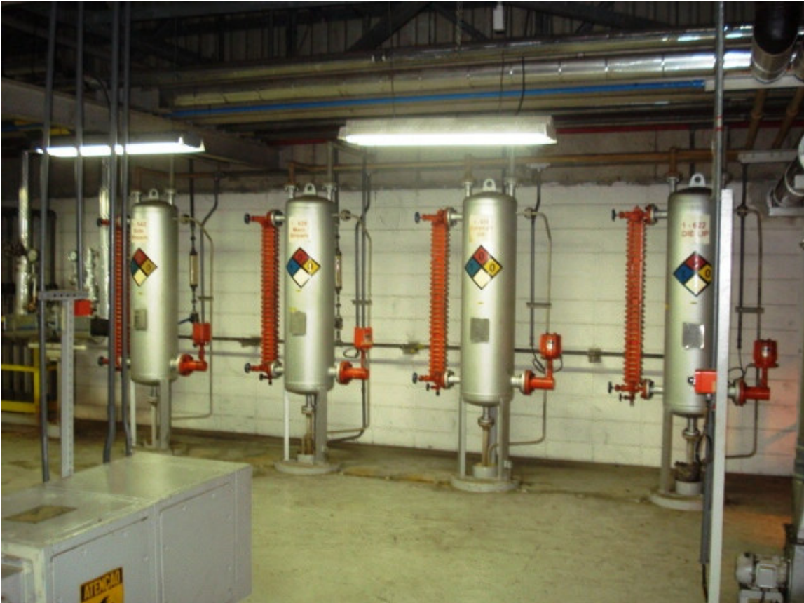
Figura 13 - Tanques de expansão da instalação
