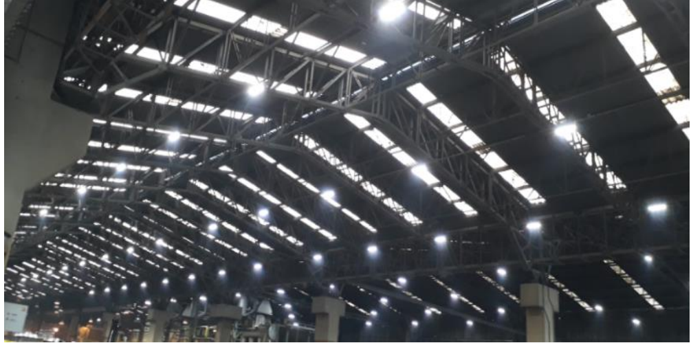
Figura 13: Iluminação da área da Refusão após a implementação das luminárias
