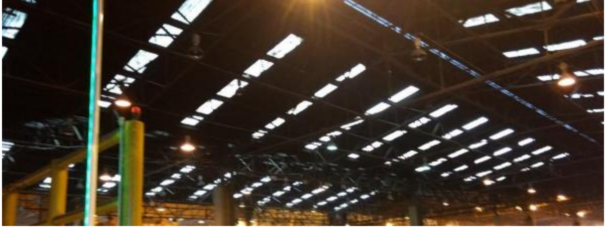
Figura 10: Iluminação pátio de matéria prima antes da realização do projeto
