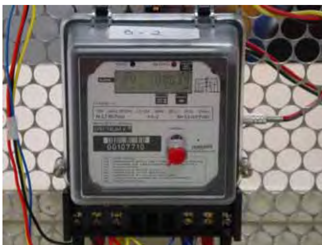
Figura 3.14 - Detalhe de medidor com instalação de transdutor óptico para o “sinal de pulso” de kWh
