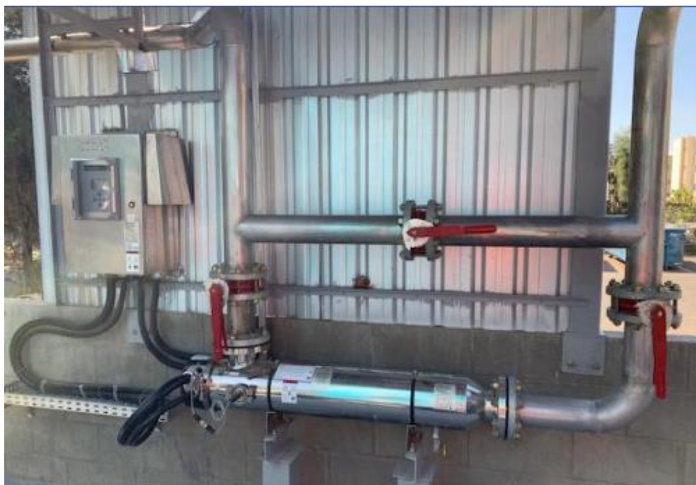
Figura 8 - Equipamento com radiação UV.
