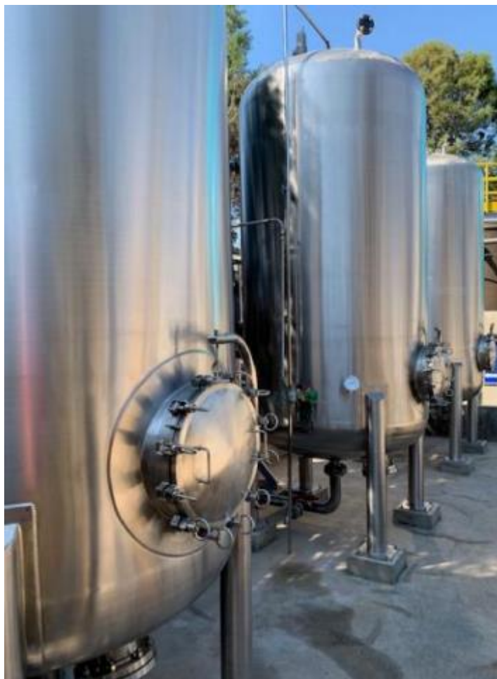
Figura 10 - Filtros de carvão ativado.
