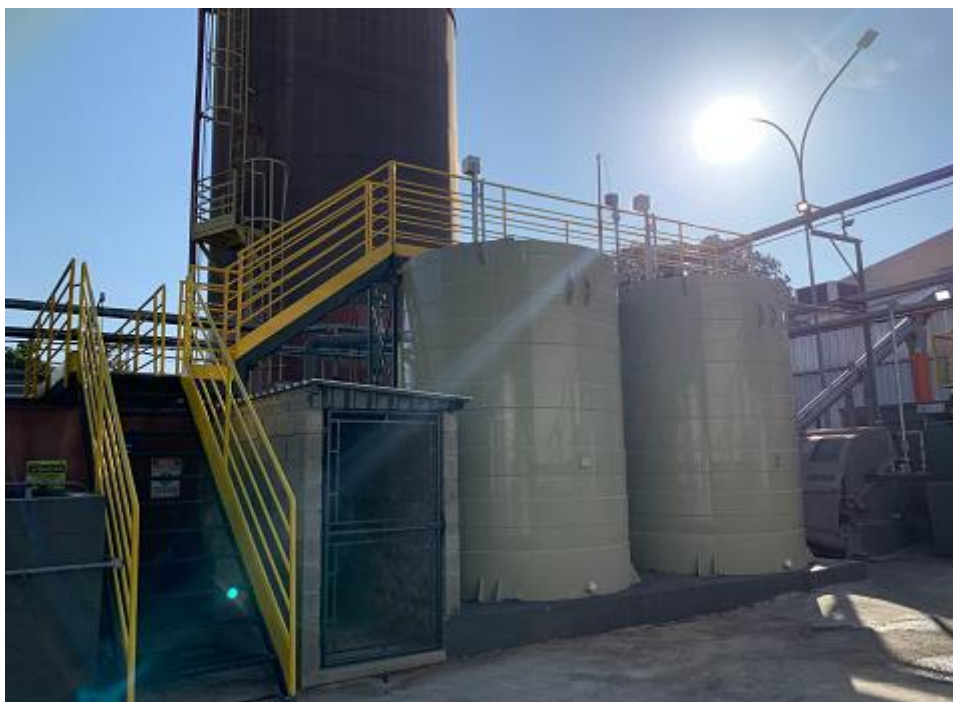
Figura 4 - Tanque de coagulação e floculação.
