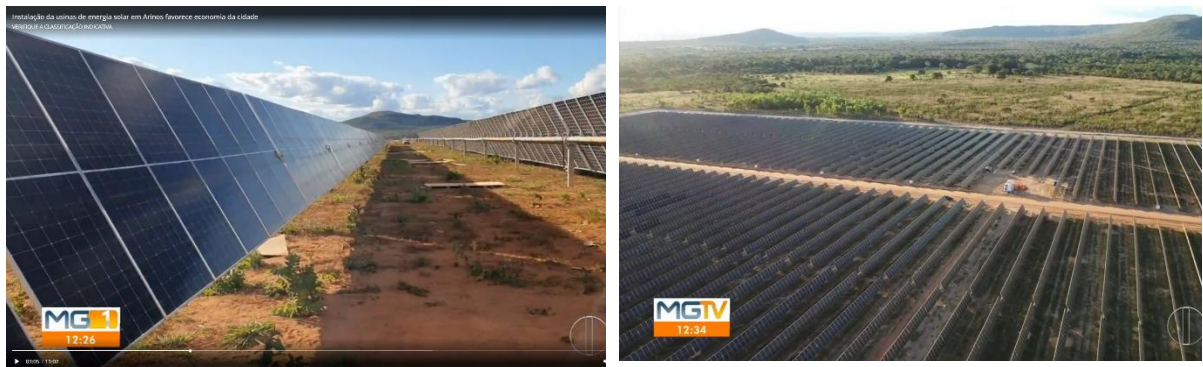
Figura 7 – Painéis instalados no empreendimento em Arinos
