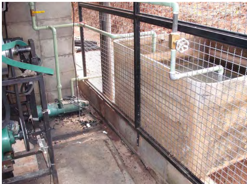
Figura 44 - Vista do condensador.
