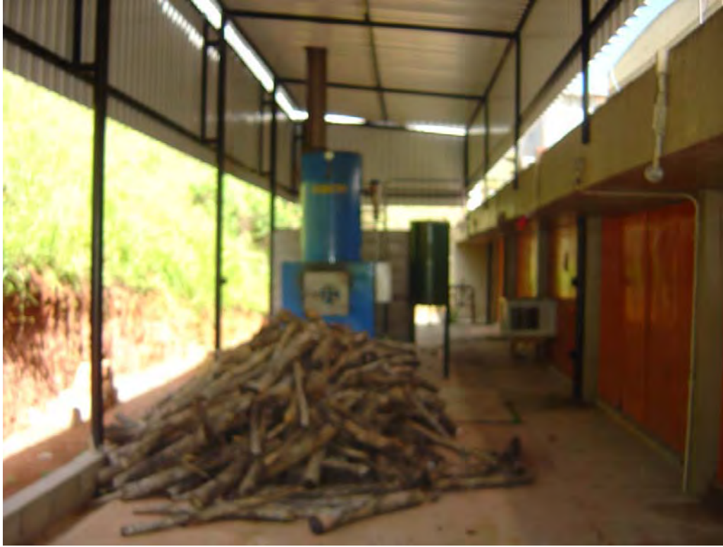
Figura 43 - Vista da caldeira.
