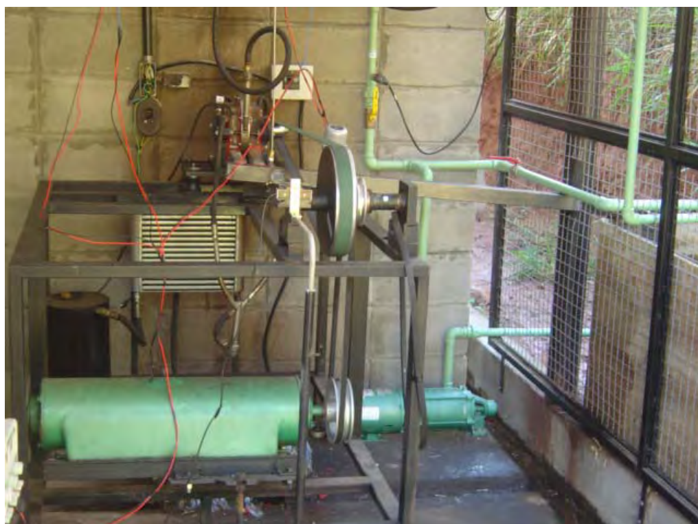
Figura 41 - Vista da turbina acoplada ao gerador.
