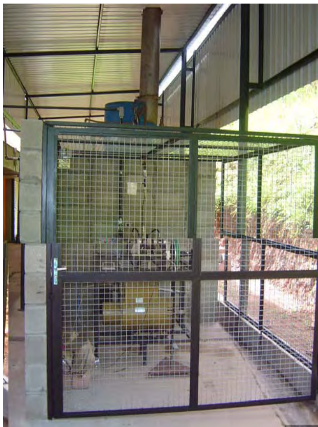
Figura 46:- Vista do sistema protegido por parede e grade.
