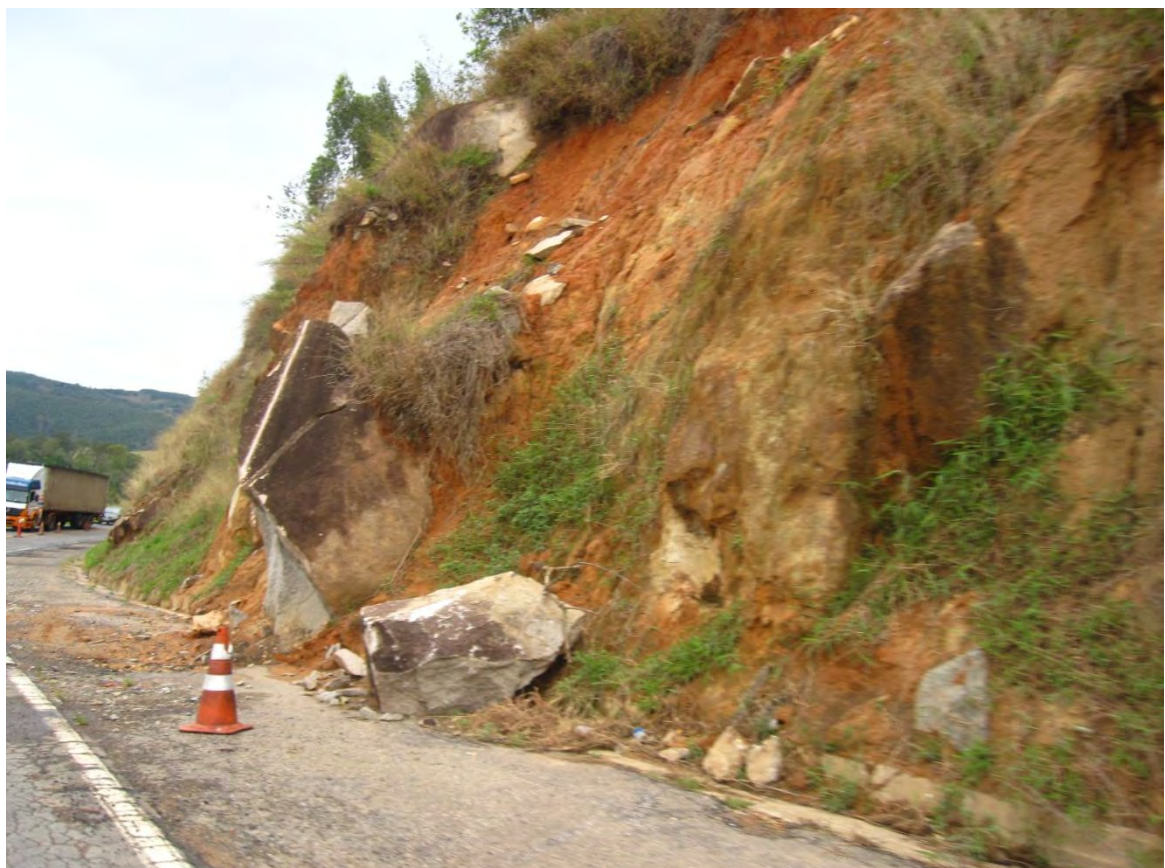
Foto 10 – Detalhe de escorregamento de solo e rocha, junto com rolamento e queda de blocos na Rodovia SP-360. Ao fundo, percebe-se paralisação no trânsito dos veículos devido este problema.
