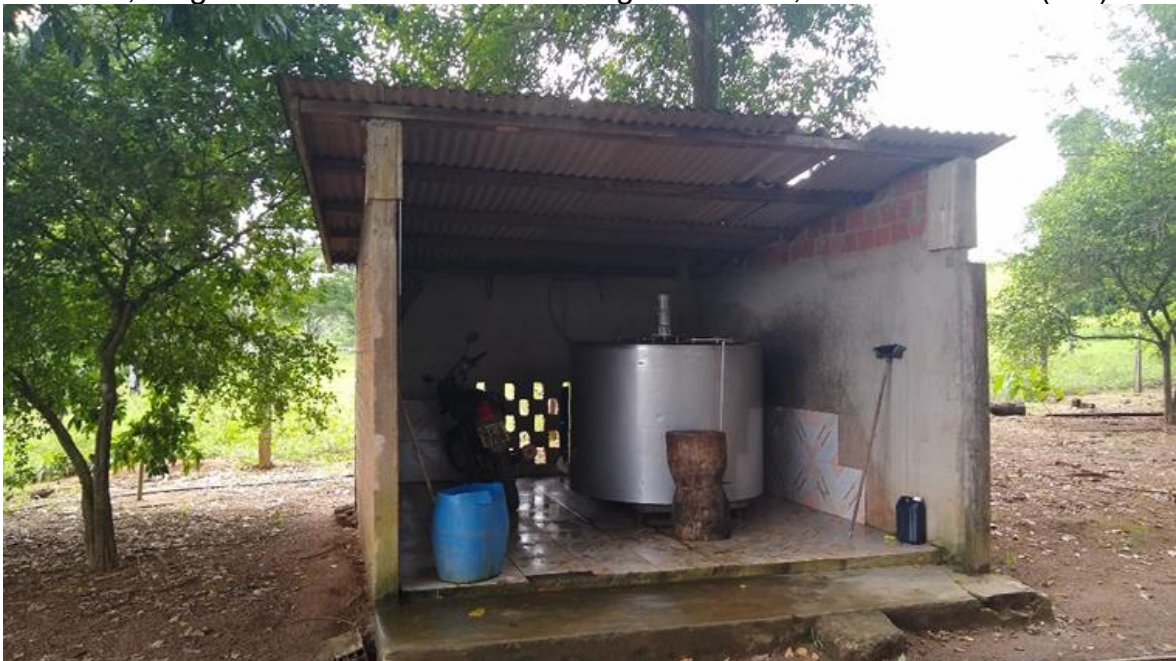
Figura 8 – Tanque resfriador de leite (pertencente à Cooperativa), em lote do senhor “ST”, na gleba 6 do Assentamento Margarida Alves, em Nova União (RO).
