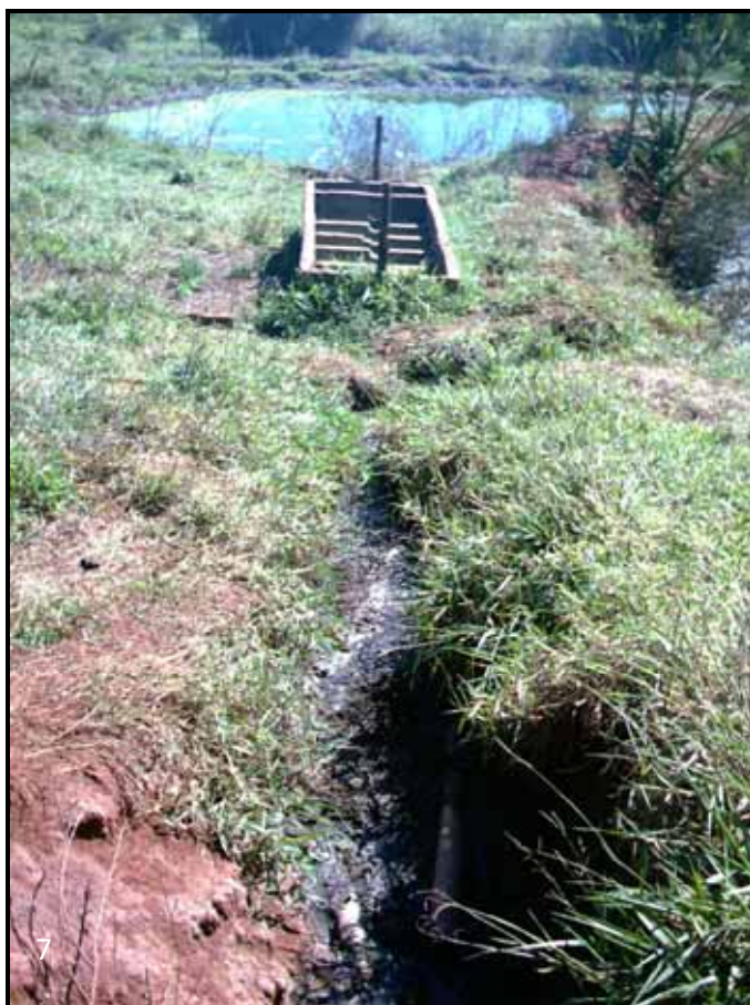
Fotos 7 – Aspectos que revelam a precariedade das instalações e equipamentos do sistema de tratamento de dejetos na propriedade 2. Fotografia: J. M. Sanabria, 08/2009.
