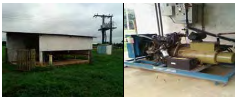
Figura 9. Grupo gerador a biogás (50 KVA).
