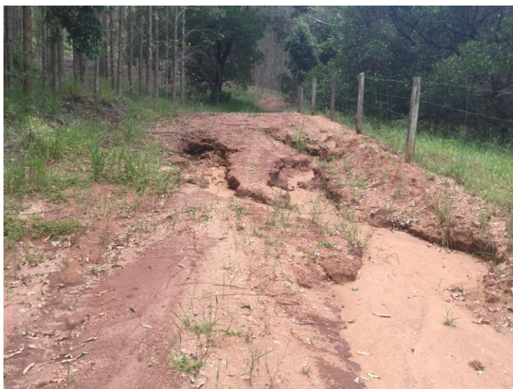
Figura 8: Erosão laminar em estrada interna
