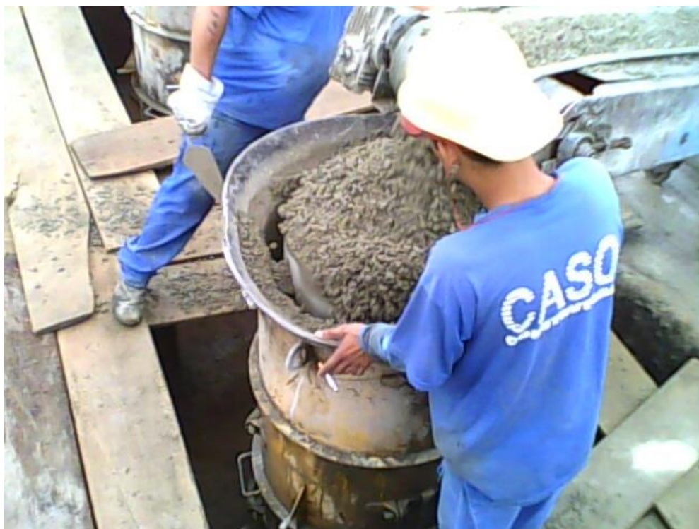
Figura 14 - Concreto caindo entre a forma interna (núcleo vibratório) e forma externa
