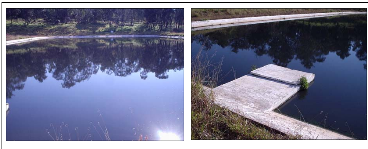
Figura 7. Da esquerda para a direita; vista da lagoa de estabilização anaeróbia e local de entrada do esgoto bruto (acima); plataforma de saída do efluente para a lagoa facultativa primária.
