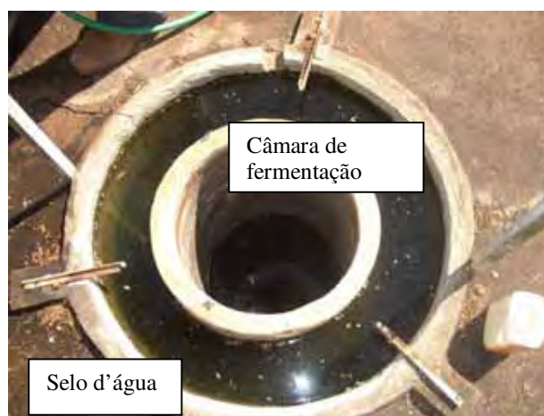
FIGURA 2 – Vista parcial do biodigestor batelada instalado no Departamento de Engenharia Rural utilizado no experimento, detalhe da câmara de fermentação e selo d'água.
